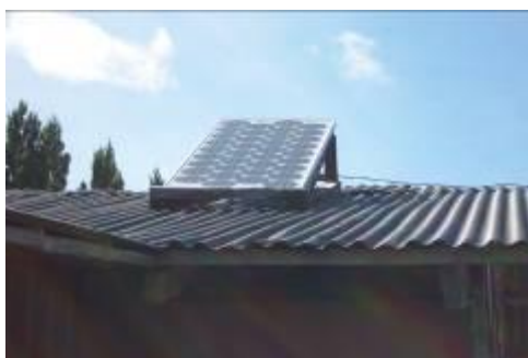
Fotografía 001.1 Vivienda 001 Carlos Oyarzo V. Panel FV de 75 watts.
